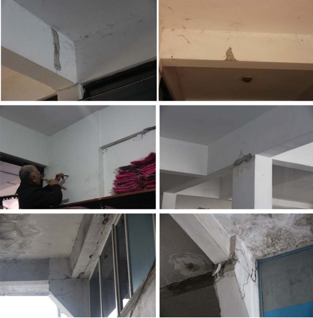
Şekil 11 - Betonarme binalarda yapısal hasar örnekleri (devam)
