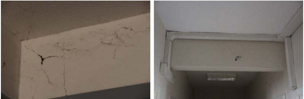
Şekil 11 - Betonarme binalarda yapısal hasar örnekleri
