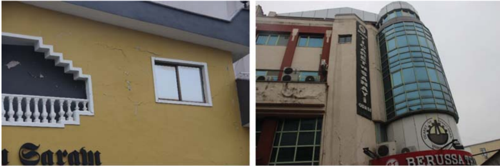
Şekil 10 - Betonarme binalarda yapısal olmayan hasar örnekleri
