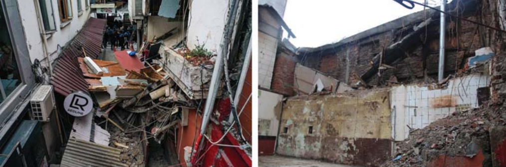
Şekil 12 - Yığma binalarda yapısal hasar örnekleri
