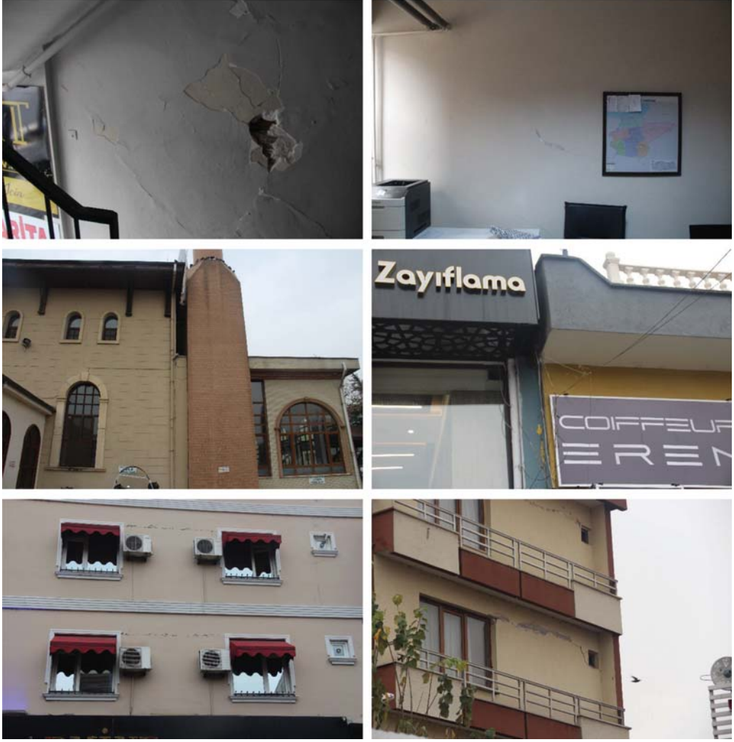
Şekil 10 - Betonarme binalarda yapısal olmayan hasar örnekleri (devam)
